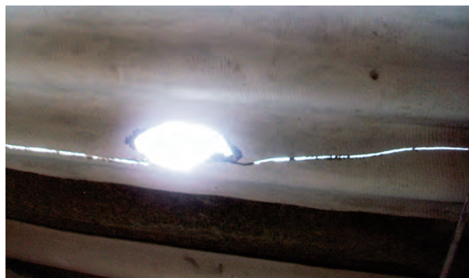
Une partie du toit endommagée en sachant que le toit était dans cet état sur toute sa longueur.
